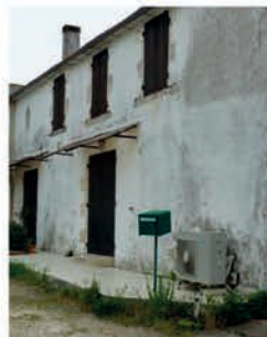
Des boîtes aux lettres qui ne sont pas intégrées aux constructions ou aux clôtures et qui perturbent la lisibilité des lieux
