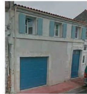
Des rez-de-chaussée dénaturés par les portes de garage
