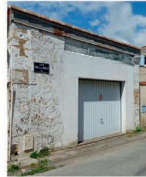
La création de porte de garage sans tenir compte de la composition de la façade et en employant des matériaux inadaptés au bâti ancien
